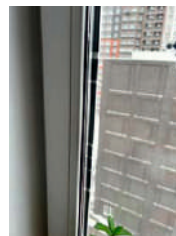
Рис. 3. Растрескивание и усадка уплотнителя стеклопакета на объекте
